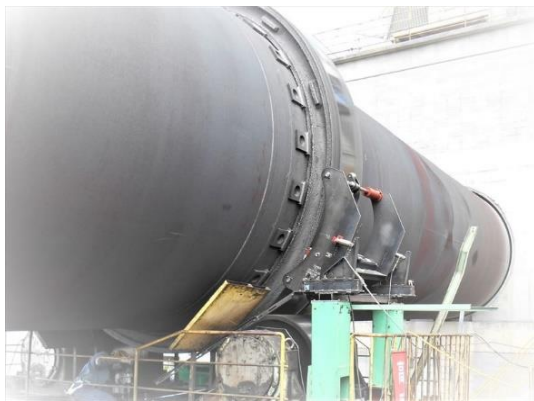
▲中央に写っているのが宏和機工製作の装置
